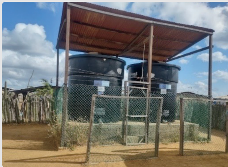
Foto 7 Sistema de almacenamiento de agua 20.000 litros - 3 De abril 20/01/2023
