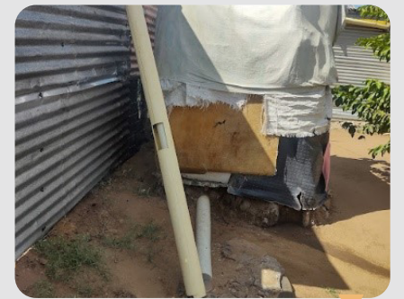
Foto 12 Pozo de infiltración con tubería de ventilación, Villa Madre Laura 18/01/2023
