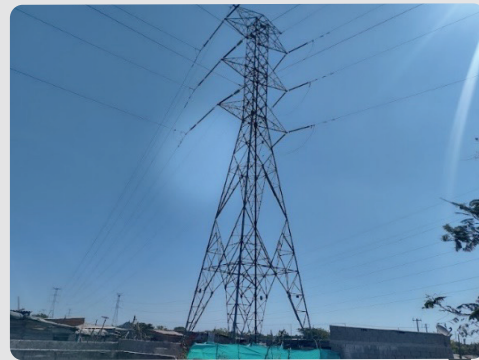
Foto 4 Torres eléctricas dentro del asentamiento Nueva Esperanza 2/02/2023
