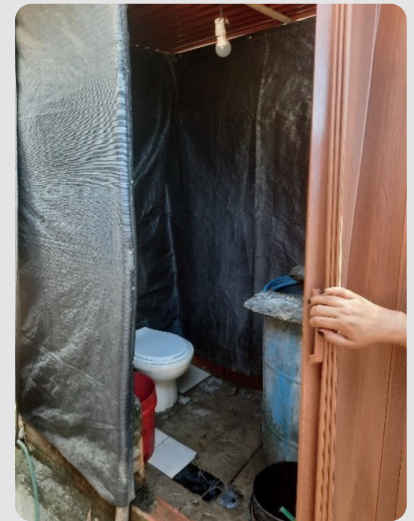
Foto 18 Adecuación espacio sanitario en vivienda – cerramiento, piso y techo. Asentamiento La Concepción- 31/01/2023
