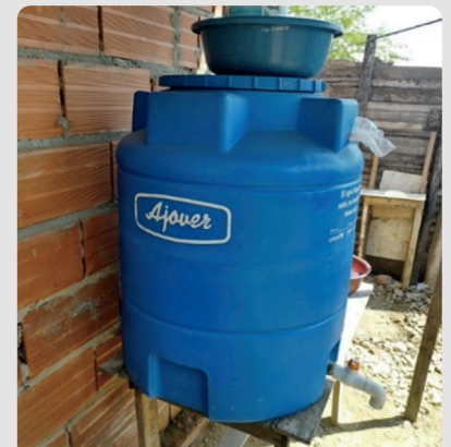
Foto 9 Tanques de almacenamiento de 250 Litros La Concepción 31/01/2023
