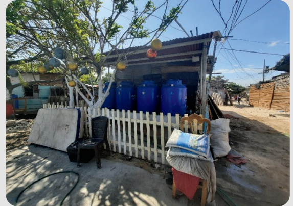
Foto 16 Punto colectivo de agua al final de la red informal. Asentamiento La Concepción. 31/01/2023
