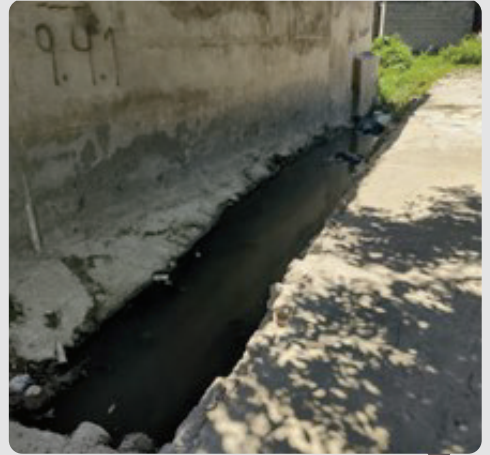
Foto 9 Vertimiento de agua grises asentamiento Villa del Re. y2/02/2023
