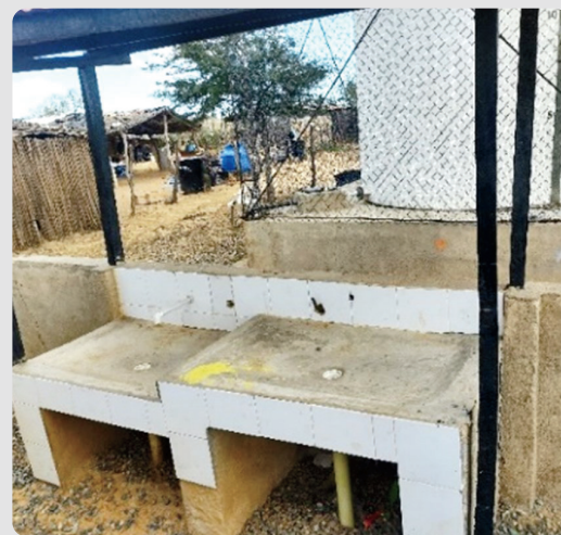
Foto 8 Punto de abastecimiento Villa Ramon 19/01/2023
