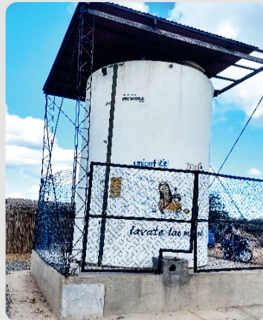
Foto 7 Sistema de almacenamiento de agua 25.000 litros Villa Ramon 19/01/2023
